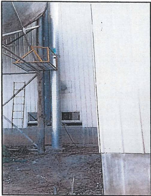
废气监测平台
